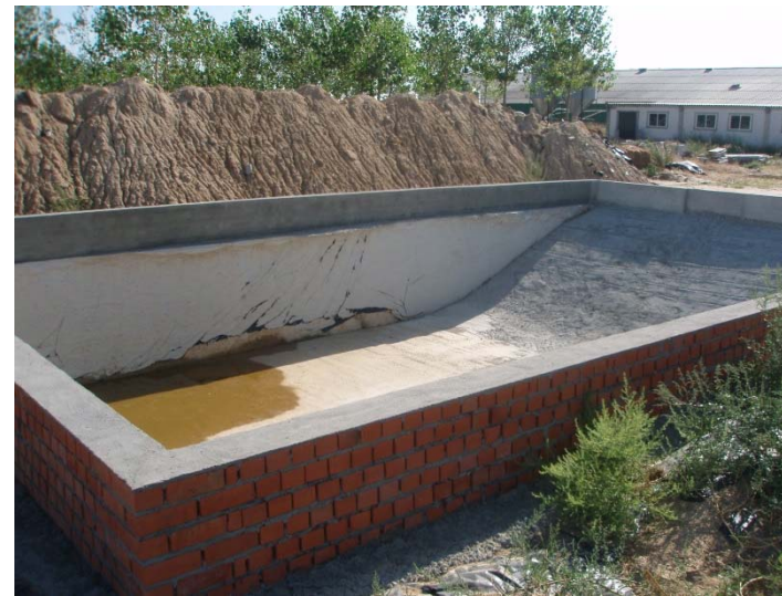
Tanque de almacenamiento usado como tanque de sedimentación.
